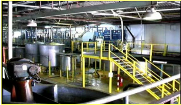
DIOXITEK UO 2 Production Plant
